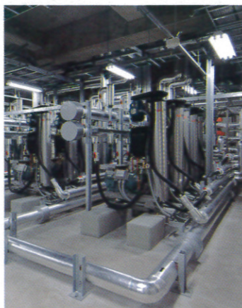
ポンプステーション
